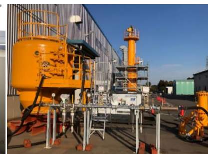
写真-3 マンロック及び送排気設備
