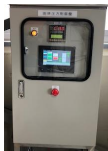
写真-2 自動減圧システム制御盤
