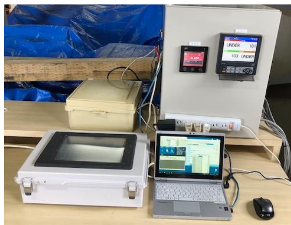
写真-1 減圧管理システム機材と記録計
