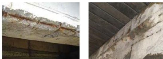
写真-2 塩害による剥離・鉄筋露出の例
