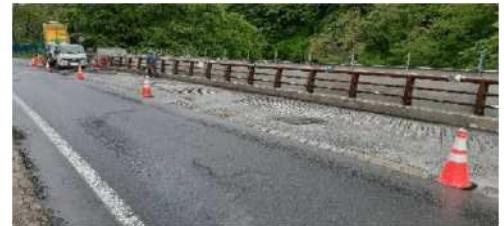
写真4 土砂化の状況
