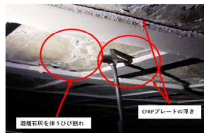
写真 3 CFRP プレートとひび割れの状況
