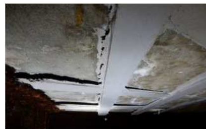
写真 2 CFRP プレート剥がれ状況(2020)
