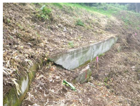
写真-2 縦壁部の破損と排水溝土砂堆積
