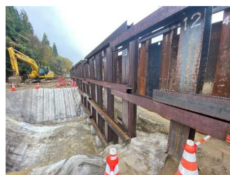
写真-1 透過型土砂防護柵の設置状況
