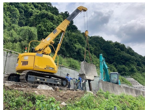
写真2 中央分離帯の剛性防護柵
