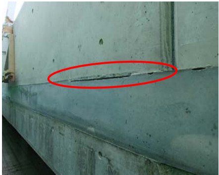
写真-2 モルタル空隙発生箇所
