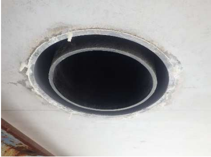
写真-5 無対策桝の下面
