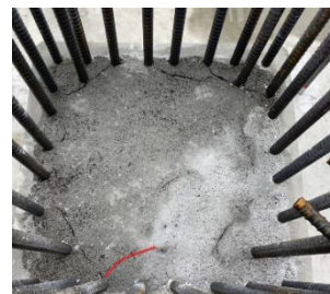
図-5 ひび割れ②
