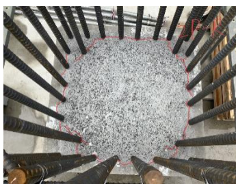
図-4 ひび割れ①
