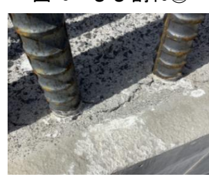
図-7 ひび割れ①近景
