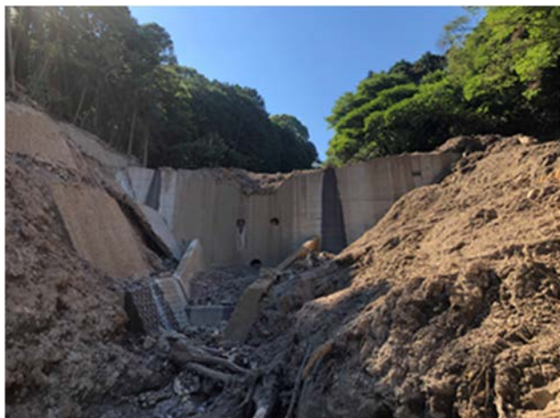
写真-1 既設砂防堰堤の被災状況
