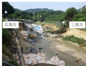
写真-2 被災状況
