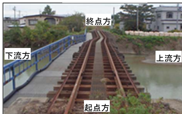
写真-2 軌道被災状況
