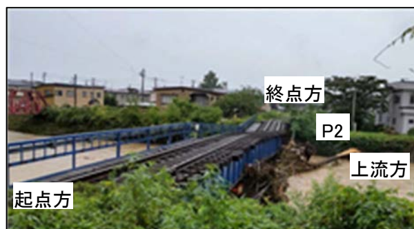
写真-1 被災状況全景
