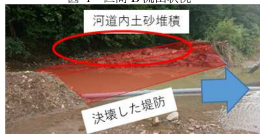
図-5 部外河川の破堤状況
