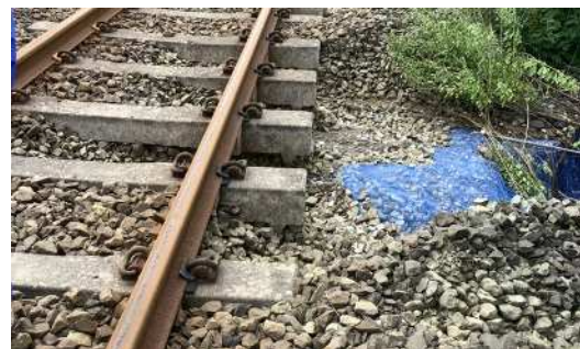
図-4 区間 B 流出状況
