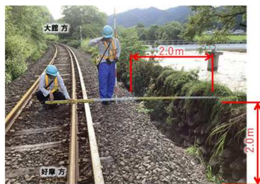
図-1 被災状況写真
