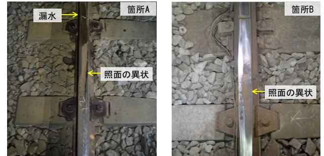
図3 健全度低下箇所の外観
