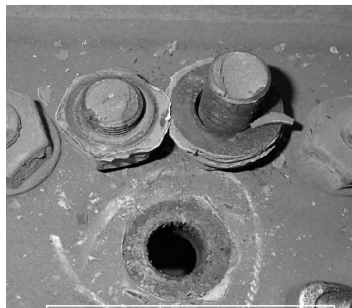
図 2、破断ボルトの拡大写真
