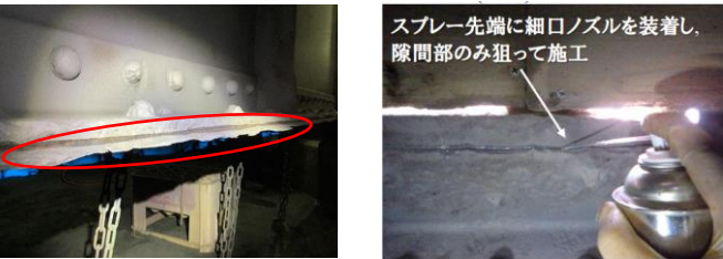
図-8 隙間部に発生した錆 図-9 素地調整軽減剤
