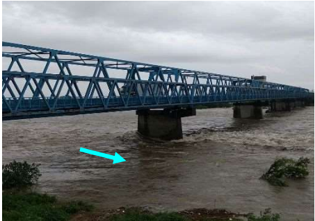
写真1 令和3年5月20日から21日の出水
