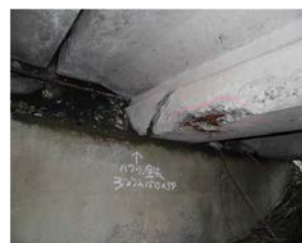
図 3 せん断ひび割れ
