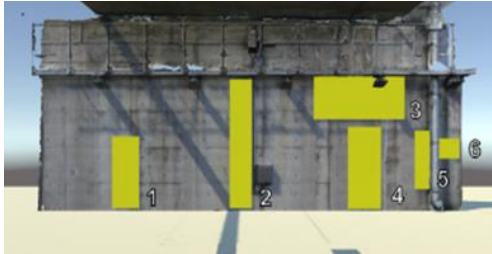
図 2. A1 橋台の損傷領域
