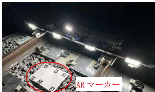
図-4 建築限界測定器フレーム（照明設置状況）
