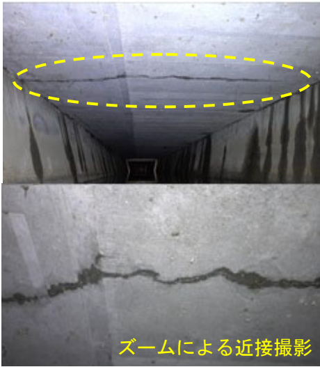
写真-3 損傷状況
