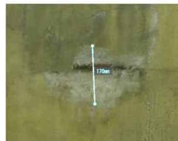
図・4：鉄筋露出箇所
