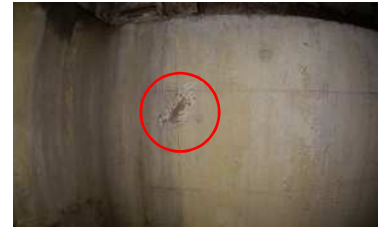
写真・2：鉄筋露出状況
