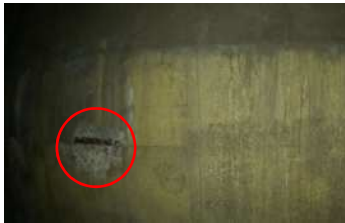
写真・3：剥落後箇所（2回目）
