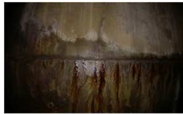
写真・1：漏水状況
