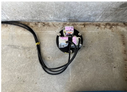
写真-2 加速度計設置状況
