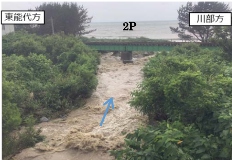
写真-1 増水時橋りょう状況
