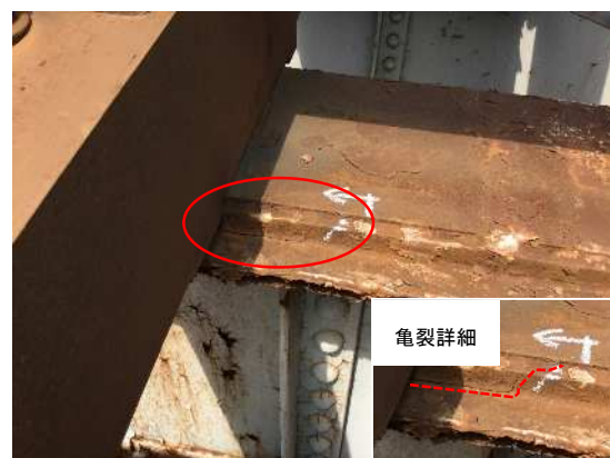
図-2 溶接部亀裂状況
