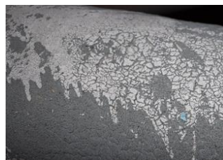
写真-1 ケーブル表面状況
