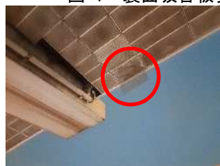
写真-1 損傷発生状況
