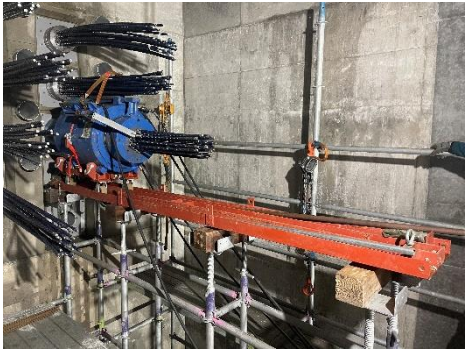
写真-2 緊張ジャッキ架台
