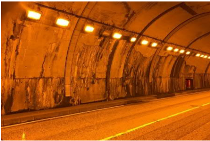
写真-1 老朽化したトンネル(在来工法)
