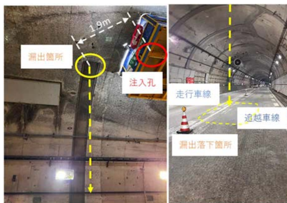
図-6 Tトンネル漏出事象
