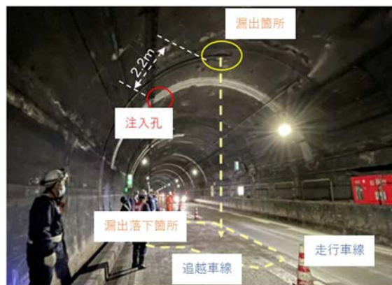
図-4 Iトンネル漏出事象
