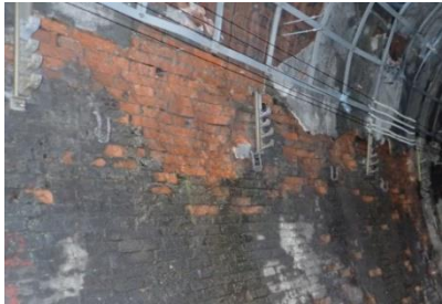
図－1 レンガ劣化状況
