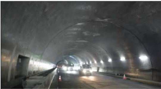
図-4 供用前の結露状況(別トンネル)
