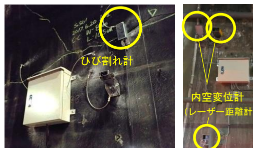
図-3 計測機器の設置状況
