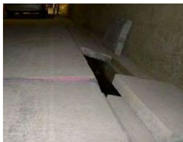
写真-1 側溝の変状
