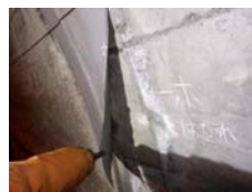
(b) はく落対策工 シート系当て板工のうき
