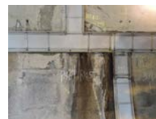
(c) 漏水対策工 導水樋工の再漏水
