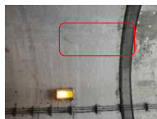
(a) 外力対策工 繊維シート補強工のうき
