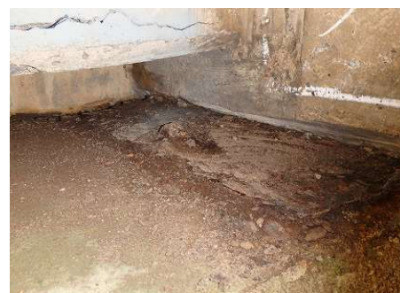
写真 4 支承部の腐食
