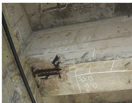
写真 3 主桁の剥離・鉄筋露出
