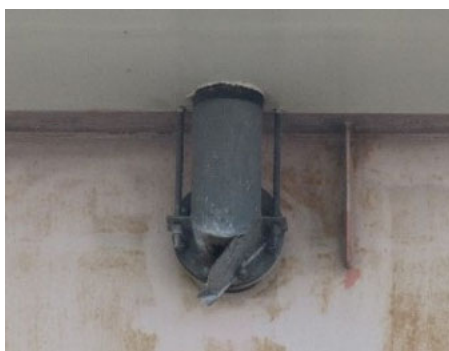
写真-1 鋼製排水管の損傷状況
