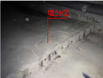
写真-2 変状状況②
