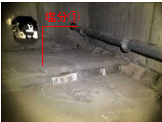
写真-1 変状状況①
