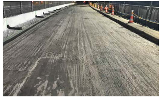
写真-1 既設床版面（不陸状態）
