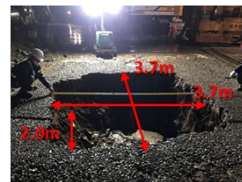
写真-3 地盤陥没状況
