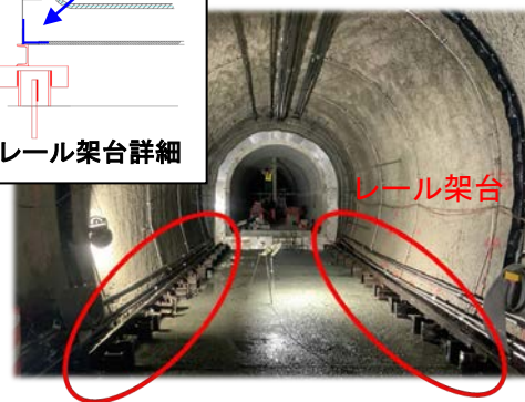
写真 2 下部レール架台
