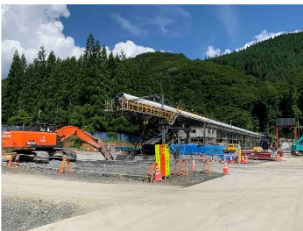
写真-2 坑外ベルトコンベヤ
