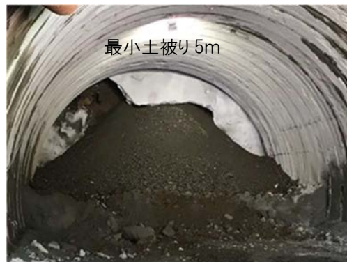
写真－2 TD.40 天端抜け落ち状況
