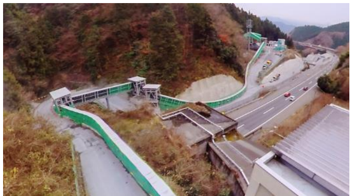
写真-1 コンベヤ設置状況（坑外ずり仮置き場方面）
