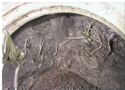
写真-1 天端崩落状況（高田山トンネル）
