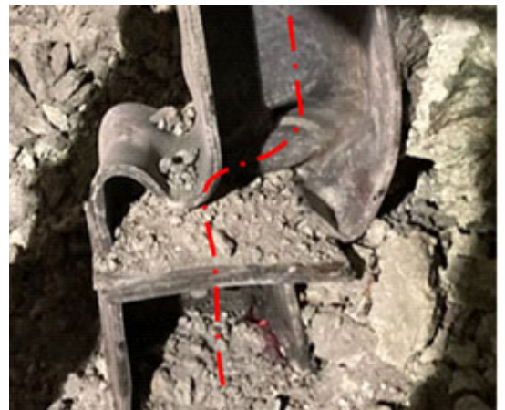
写真-1 鋼製支保工座屈状況
