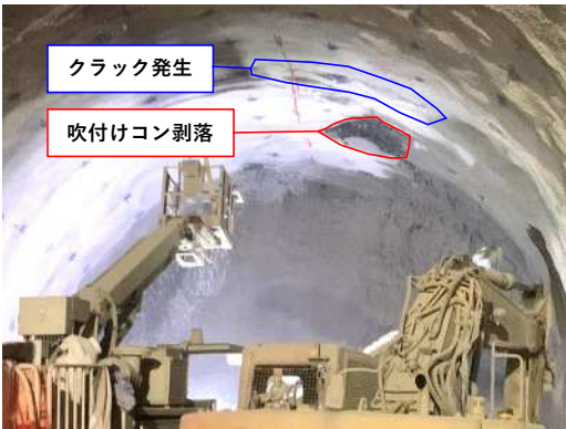
写真-1 変状状況
