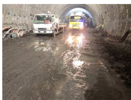
写真-2 路盤泥濘化状況
