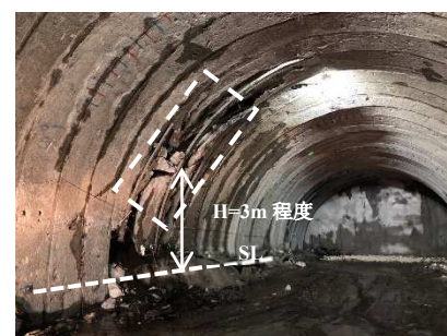
写真-4 下り線支保工変状状況
