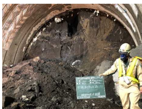
写真-1 切羽崩落状況
