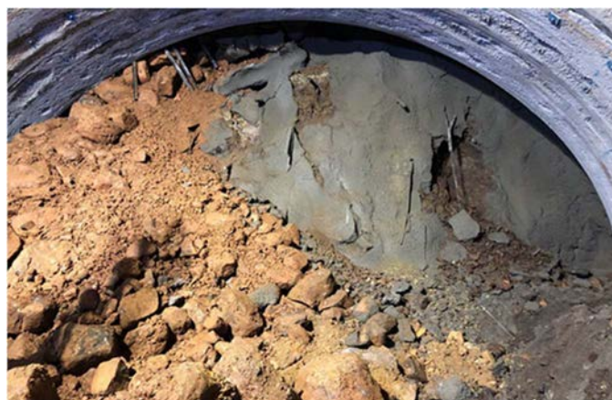
写真-1 崩落時の切羽写真(支保工 No. 81)
